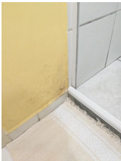
Figura 21 - Umidade devido a falta de vedação do blindex
