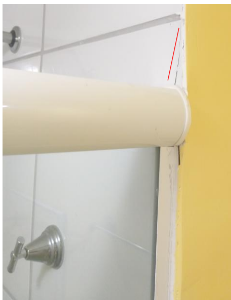
Figura 16 - Trinca no revestimento cerâmico
