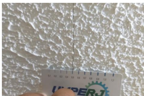
Figura 15 - Fissura na laje - Espessura 0,5mm
