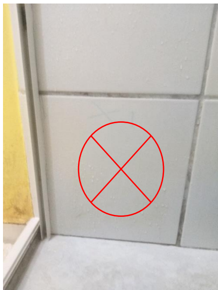
Figura 18 - Revestimento som cavo (VISTA F)
