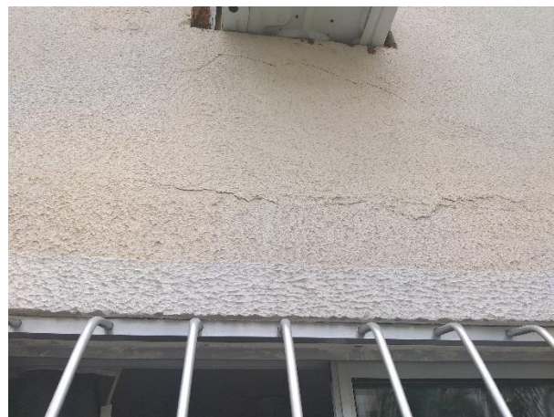
Figura 33 - Fissuras de dilatação térmica
