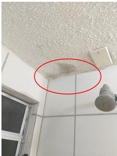
Figura 19 - Sinais de umidade no forro
