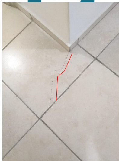
Figura 22 - Piso cerâmico trincado
