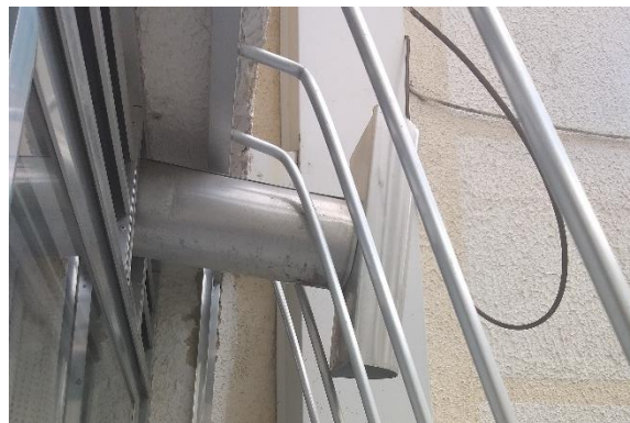
Figura 26 – Chaminé de exaustão
