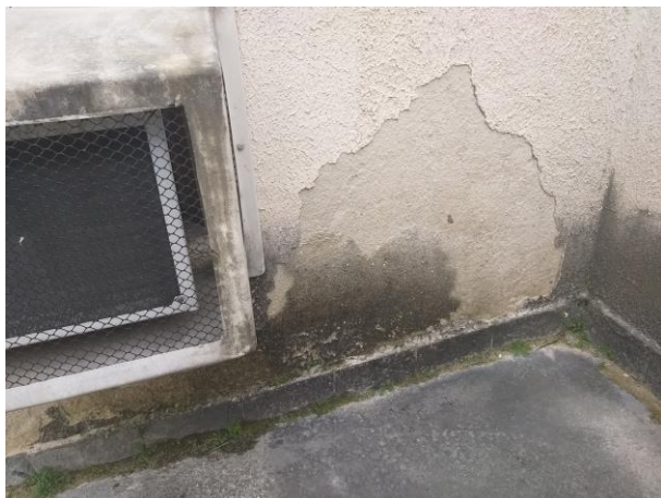
Figura 30 - Excesso de umidade / Deslocamentos com pulverulência
