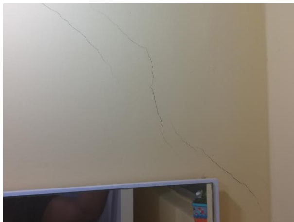
Figura 12 - Fissura predominante da argamassa (VISTA D)
