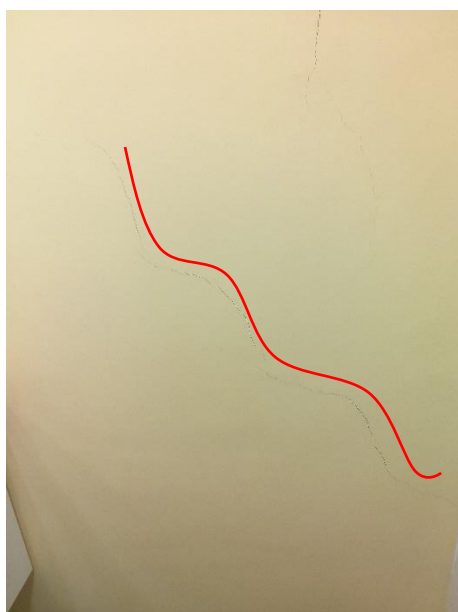
Figura 13 - Fissuras predominante da argamassa (VISTA E)
