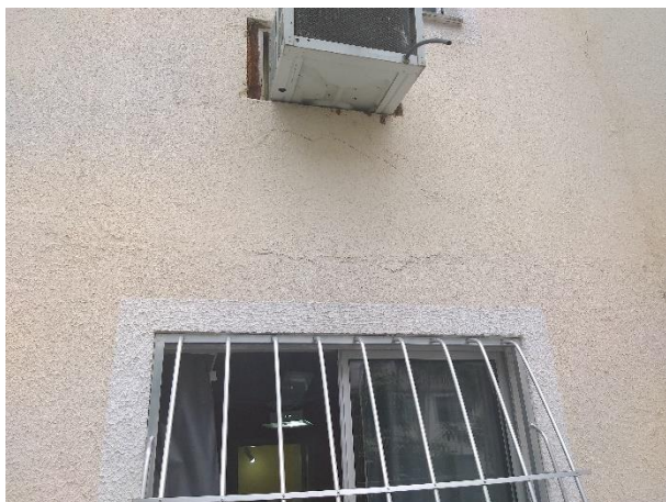
Figura 32 - Fissuras de dilatação térmica
