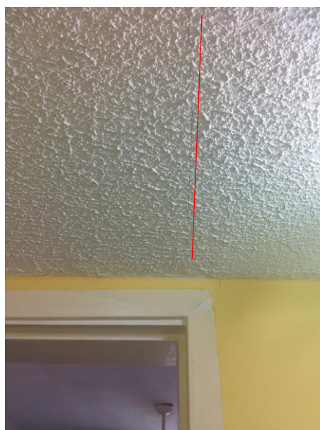
Figura 14 - Fissura na laje
