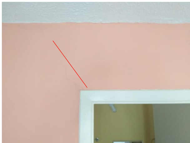
Figura 6 - Fissuras canto de porta (VISTA B)
