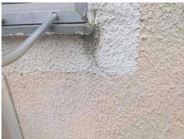
Figura 34 - Fissuras externa - ponto de infiltração
