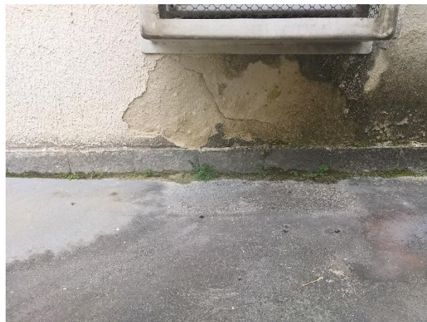
Figura 31 - Excesso de umidade / Deslocamentos com pulverulência
